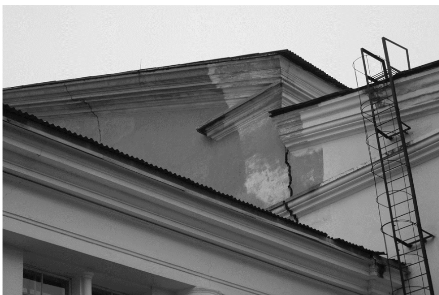
Рис. 1. Развитие трещин на здании в зоне неравномерных деформаций
